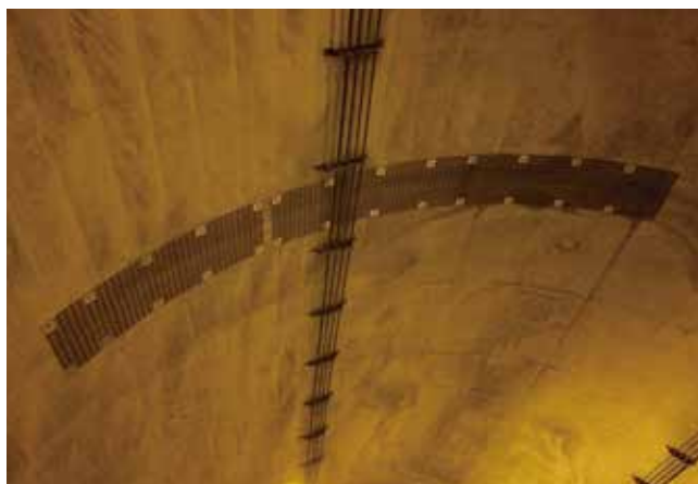
某トンネル 目地部はく落対策
